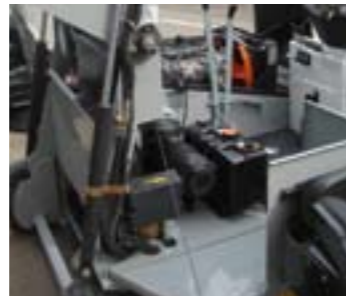
Aufgeräumte, gut zugängliche Technik. (Sweep 90 / 100 / 120)
